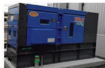
<非常用電源設備>
